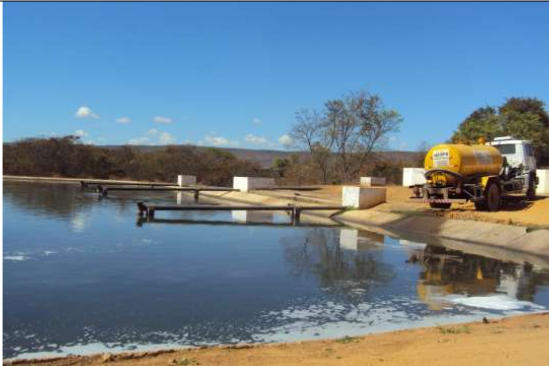
FOTO 19: estação de tratamento de esgoto em operação
