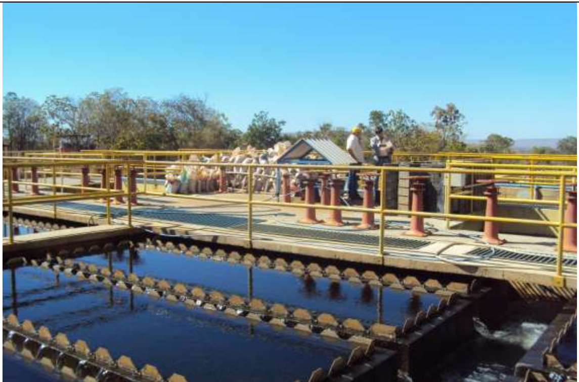
FOTO 12: filtros da estação de tratamento em operação
