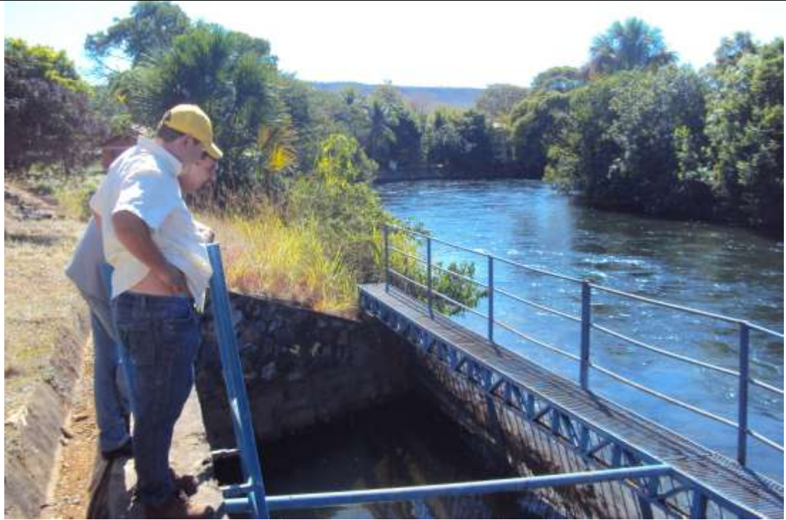
FOTO 05: captação de água bruta – cercada e protegida
