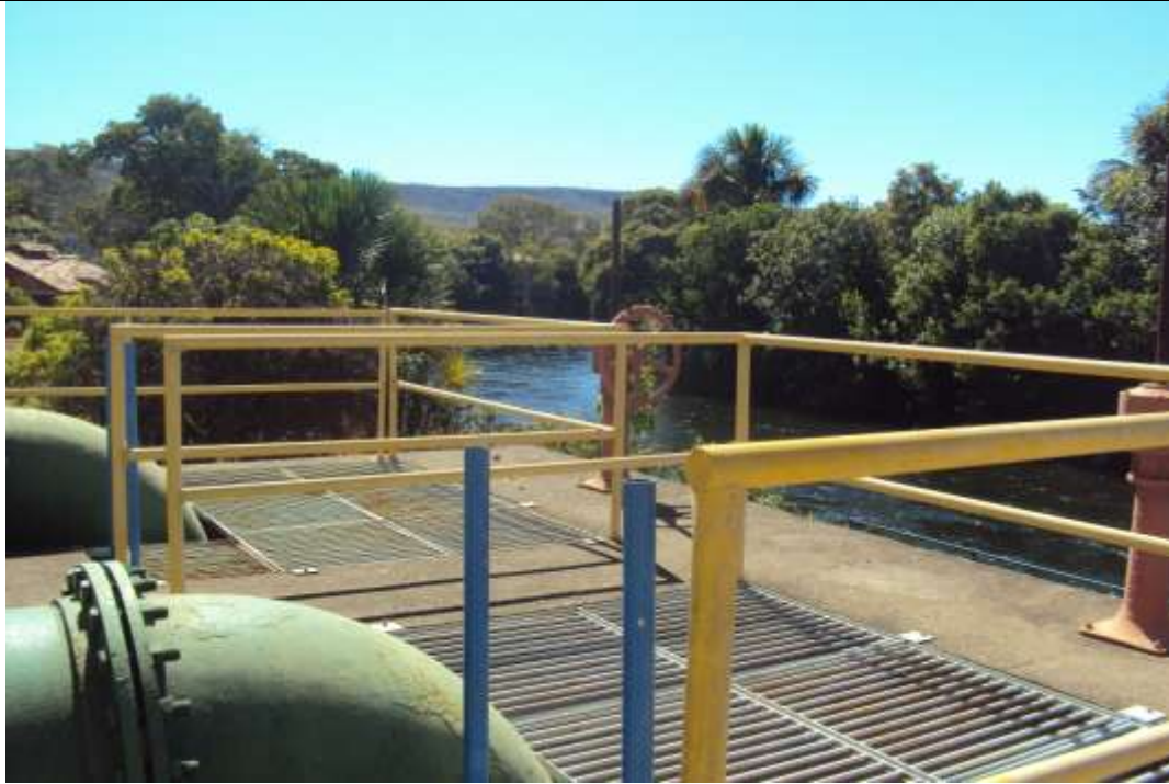
FOTO 07: adução de água bruta
