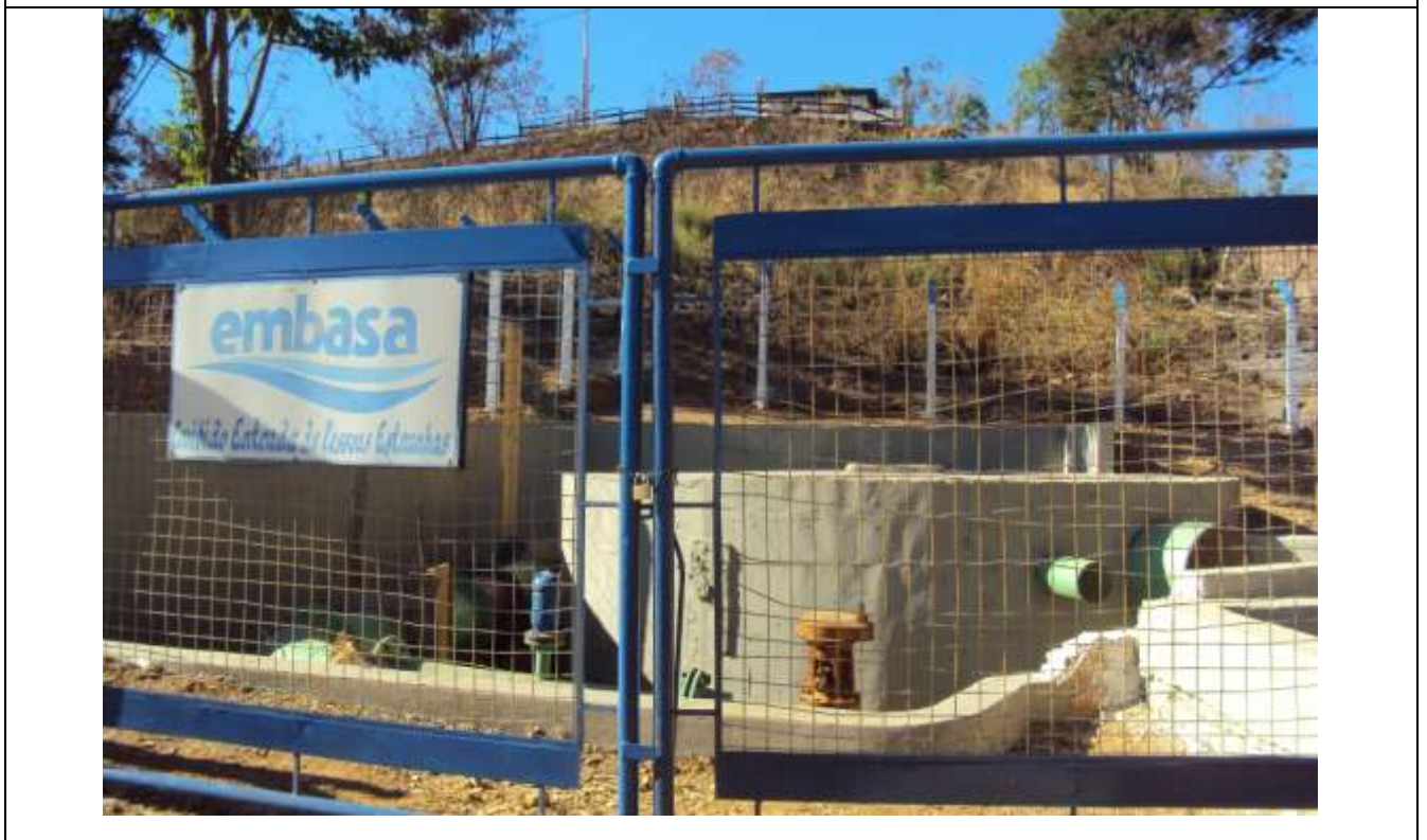
FOTO 18: Regulador de pressão da rede – cercado e sinalizado
