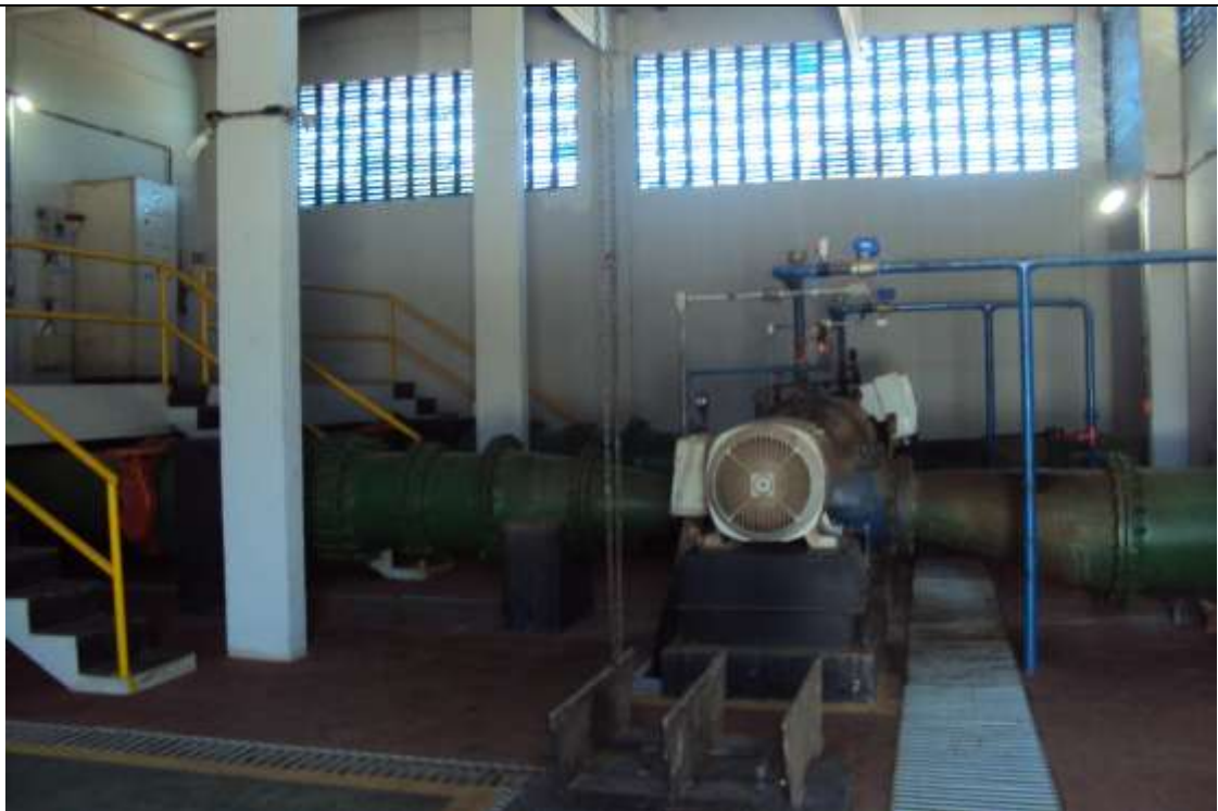
FOTO 10: acesso à elevatória – boas condições dos equipamentos
