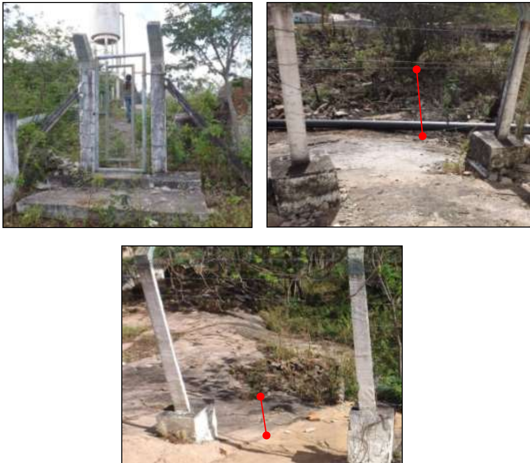
Figura 5: Área dos reservatórios sem sinalização e restrição adequada de acesso
