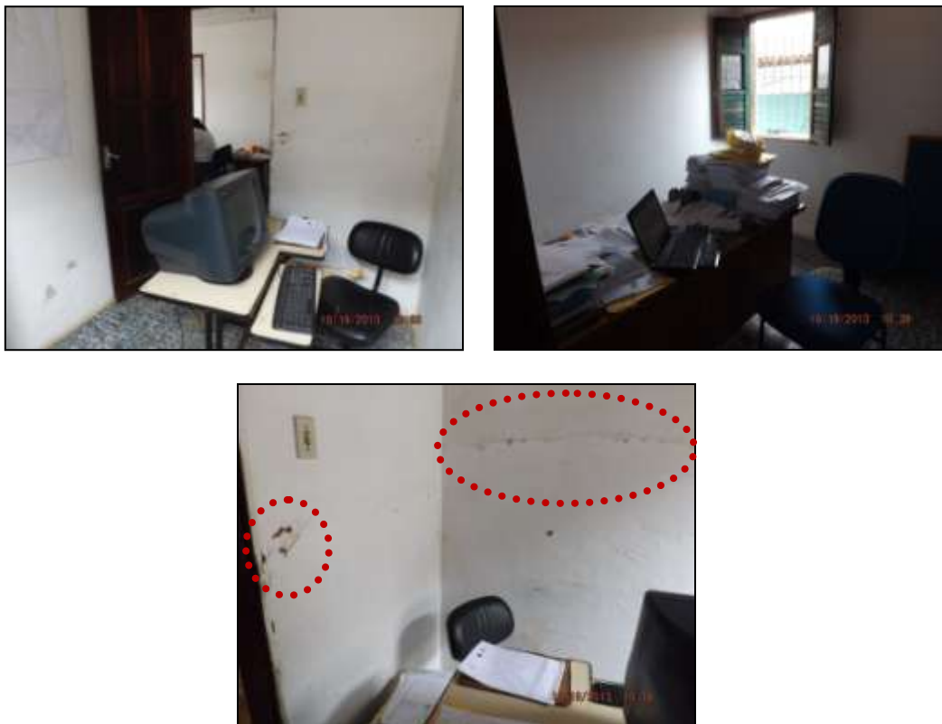
Figura 21: Condições precárias do EL.
