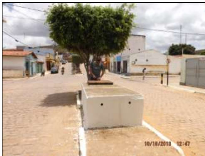
Figura 17: Booster sem sinalização.
