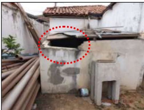
Figura 19: Tanque sem vedação adequada.
