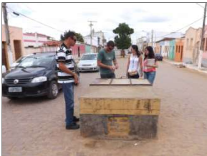
Figura 16: Booster sem sinalização e proteção devida.
