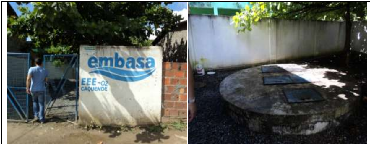
Figura 9.2 – Vista da EEE 02
