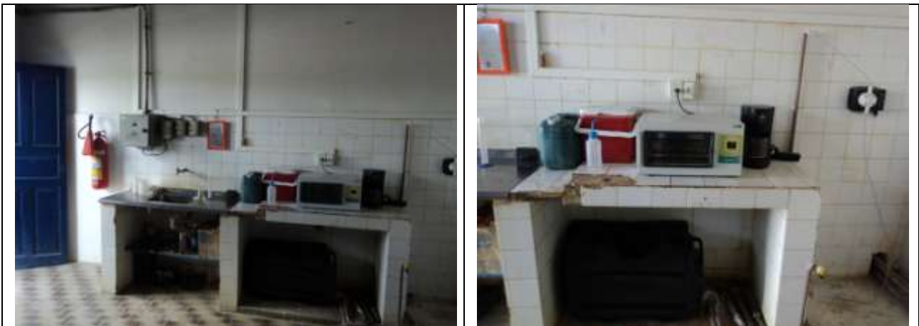
Figura 8.3 – Laboratório de Análises Físico-Químicas e Microbiológicas necessitando de reparos
