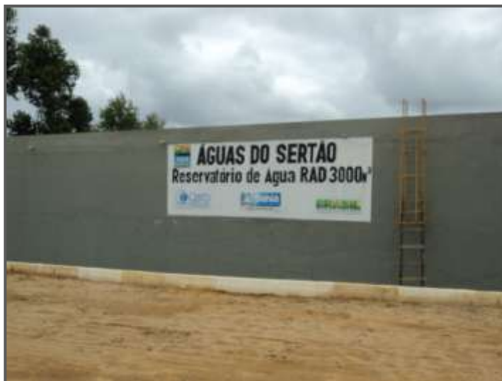
Figura 5: Reservatório Águas do Sertão.
