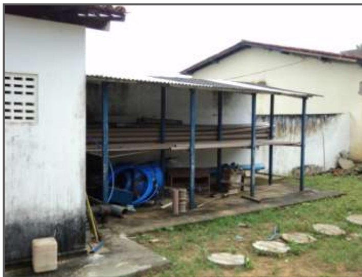
Figura 15: Almojarifado sem sinalização e organização adequadas.
