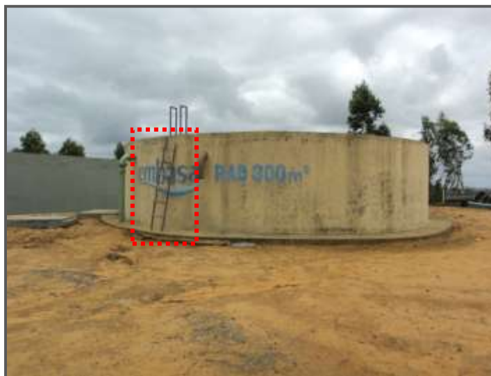
Figura 19: Reservatório sem escada fixa de acesso.
