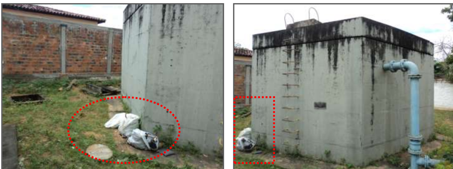
Figura 16: Acúmulo de lixo na parte externa do EL.
