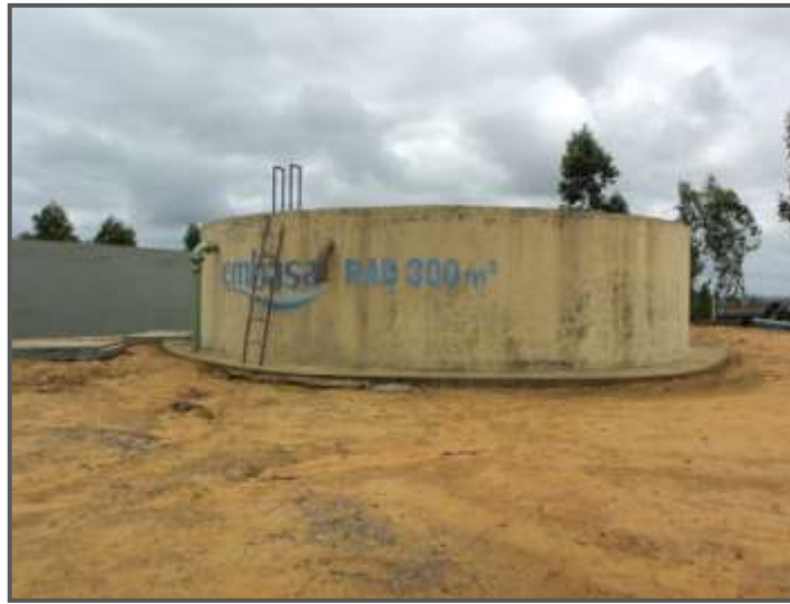
Figura 7: Reservatório apoiado com capacidade 300m 3 .
