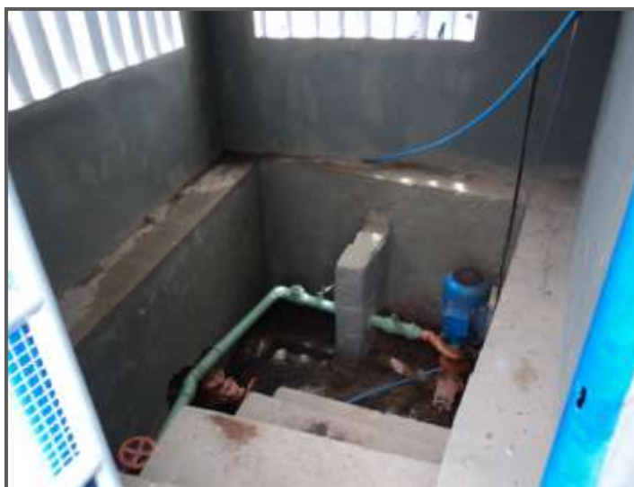
Figura 18: Área do booster : vazamento e inexistência de bomba reserva.
