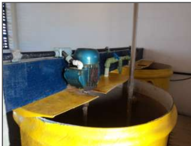
Figura 20: Corrosão no equipamento de mistura do cloro.
