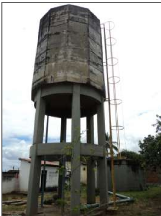
Figura 17: Ausência de guarda-corpo e para-raios na laje de cobertura do reservatório.
