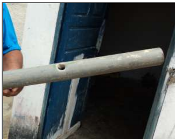
Figura 24: Exemplar de duto com evidência de perfuração.
