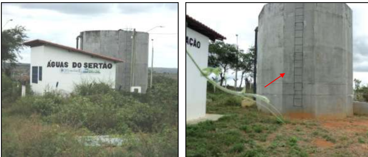
Figura 14 – Reservatório do SAA águas do Sertão sem guarda corpo
