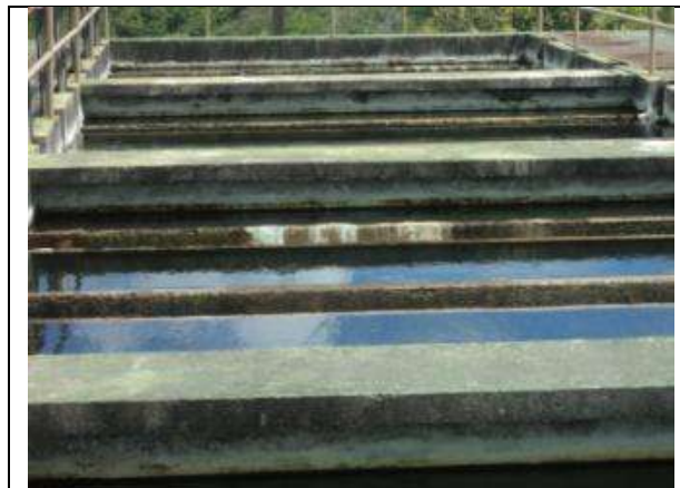
Figura 8.3 – Filtros em estado de conservação deficiente
