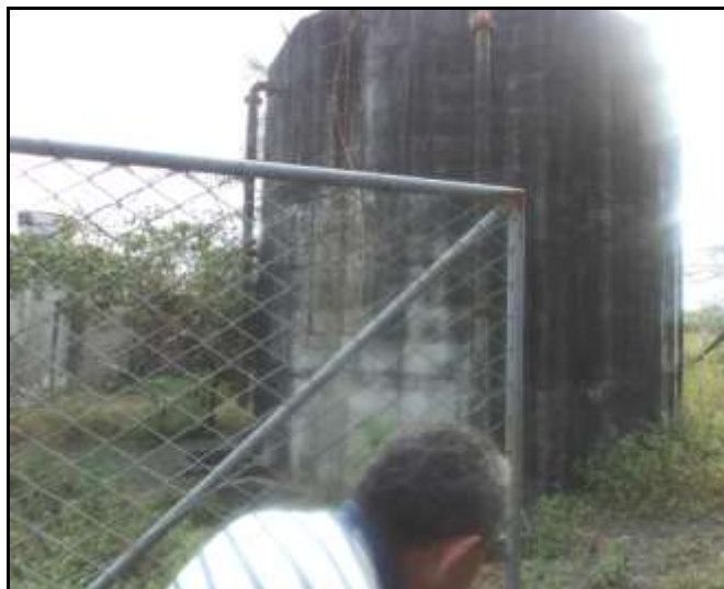
Figura 12 – Reservatório necessitando de capinação e roçagem
