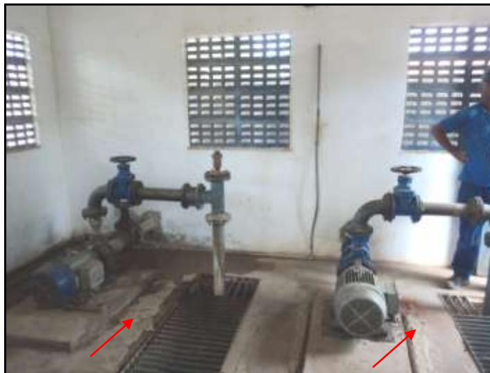
Figura 11- Interior da casa de bombas em mau estado de conservação
