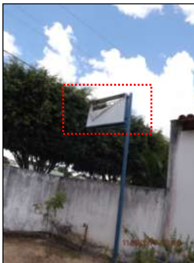
Figura 11: Placa de sinalização danificada.
