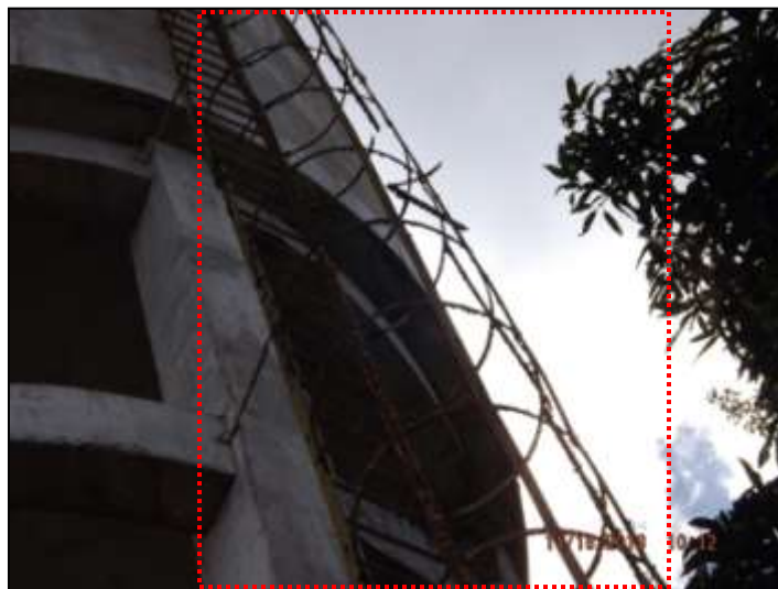
Figura 9: Escada de acesso danificada
