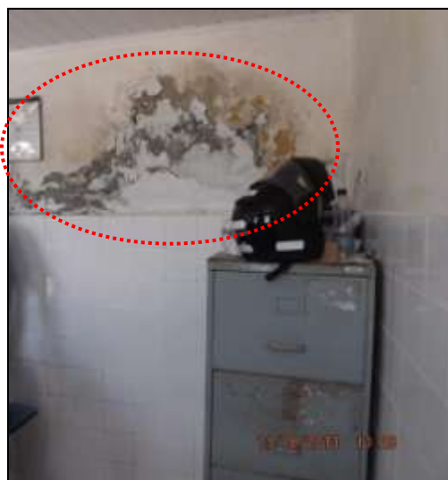
Figura 7: Infiltração na parede.
