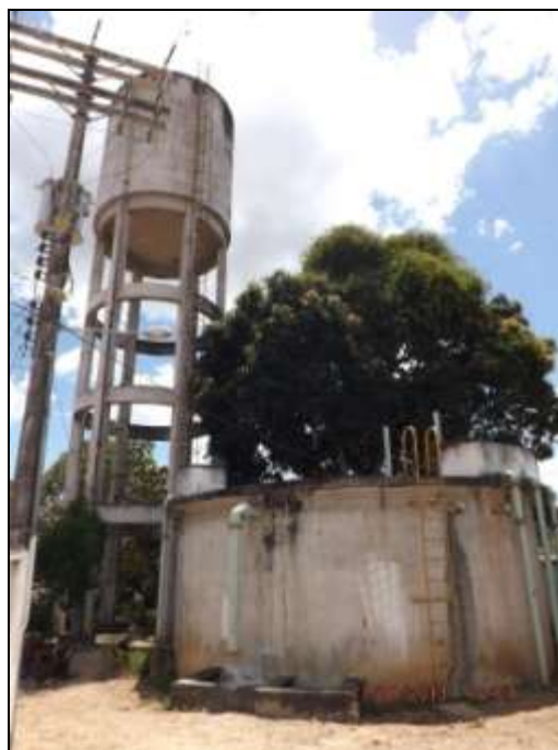
Figura 1: Reservatórios elevado e apoiado
