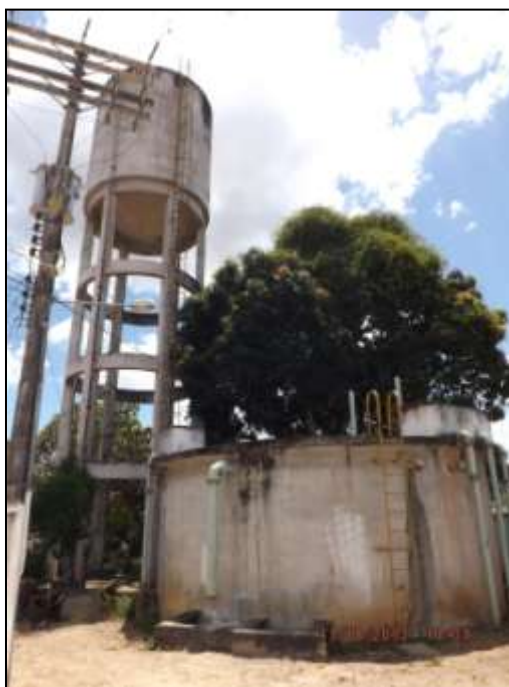
Figura 8: Reservatório elevado sem guarda-corpo na laje de cobertura e com ausência de para-raios. Ambos sem sinalização.
