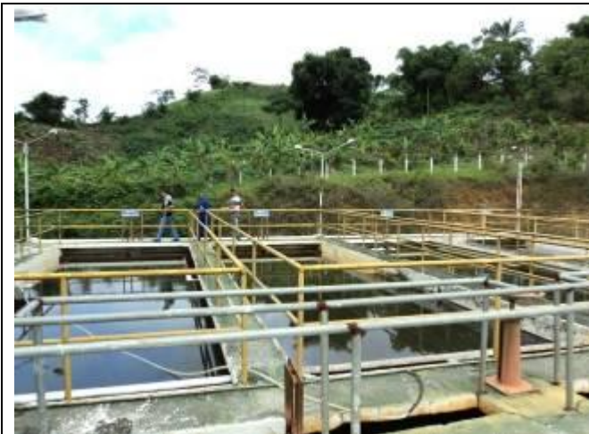
Fig. 6.10 – Vista dos decantadores em operação
