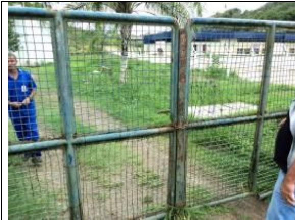
Fig. 6.8 – Portão necessitando de reparos
