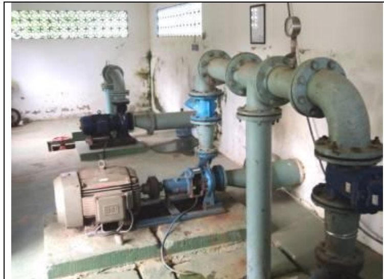
Fig. 6.12 – Interior da casa de bombas – equipamentos e edificação em mau estado de conservação
