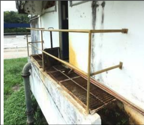
Fig. 6.6 – Instalações mal conservadas – peças enferrujadas e necessidade de pintura
