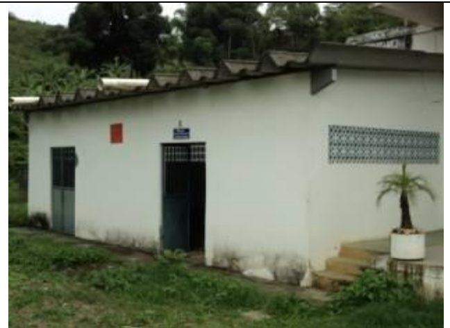
Fig. 6.9 – Área interna da ETA - necessidade de capinação e pintura
