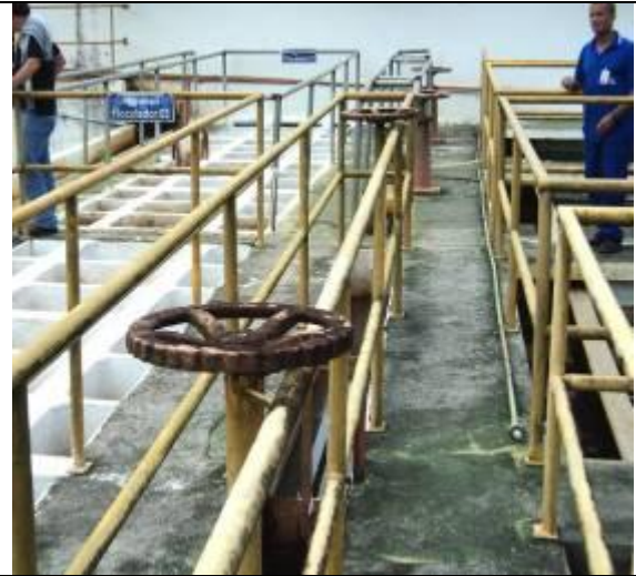
Fig. 6.7 – Instalações precárias - grades enferrujadas
