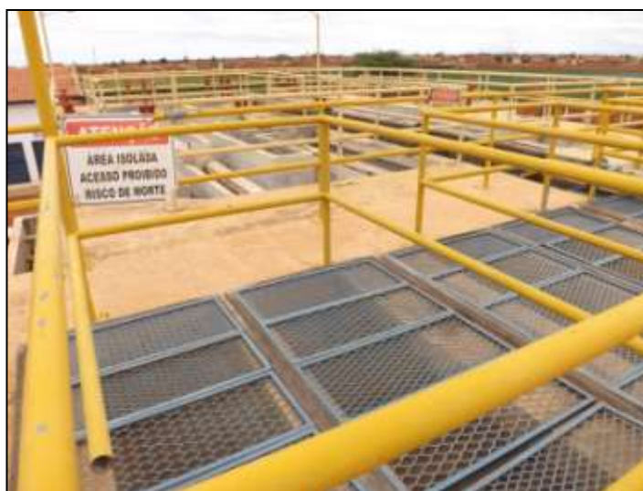
Figura 11: Ausência de sinalização de desativação.
