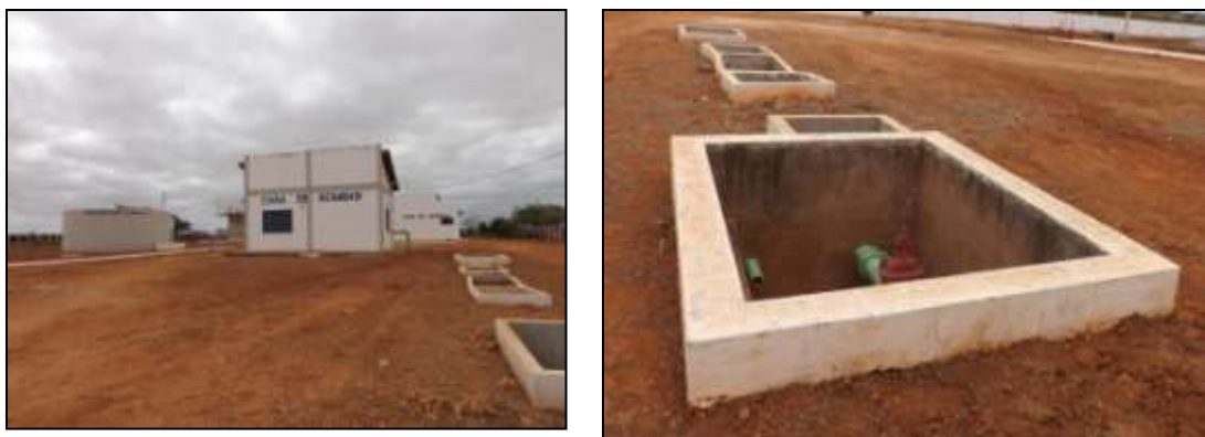
Figura 10: Ausência de tampa ou qualquer outro tipo de isolamento.
