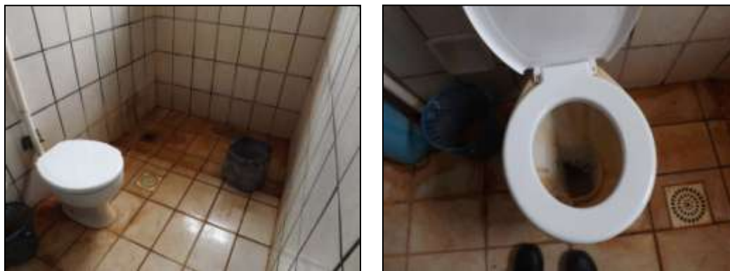
Figura 13: Banheiro em péssimas condições de uso.
