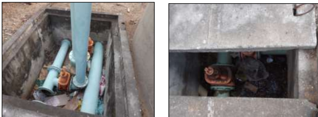
Figura 14: Falta de tampa e limpeza do local.
