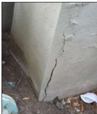
Figura 17: Fissura no bloco de apoio.
