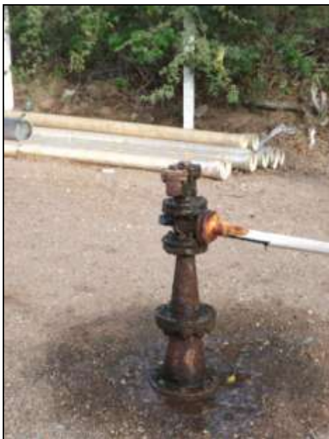
Figura 16: Ventosa com vazamento.
