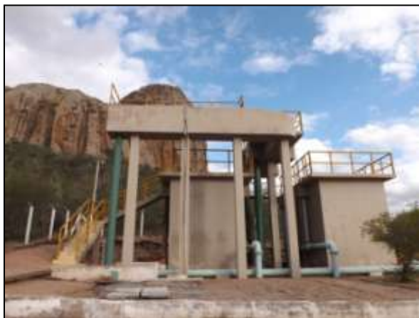
Figura 13: Unidade de tratamento (Filtro Russo) sem sinalização.
