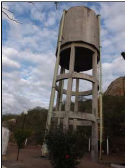
Figura xx: Ausência de sinalização do reservatório elevado.
