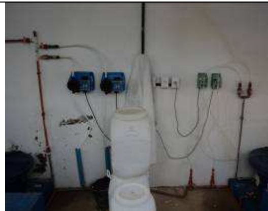
Figura 7.6 – Edificação que abriga a Casa de Química em estado precário
