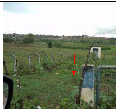
Figura 7.4 – Cerca de proteção em estado precário
