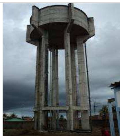
Figura 7.10 – Ausência de guarda corpo na laje de cobertura do REL 02
