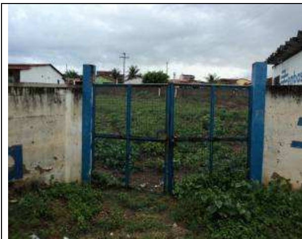
Figura 7.1– Inexistência de sinalização
