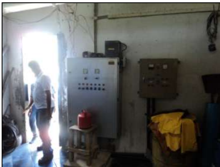
Figura 14: Fiação exposta e com gambiarras.
