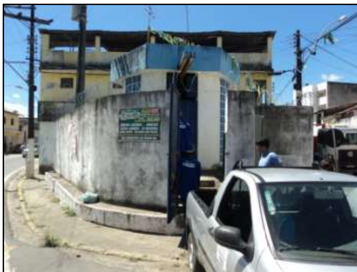
Figura 8: EEEB2 sem sinalização e acesso restrito. Ambiente necessitando de pintura.
