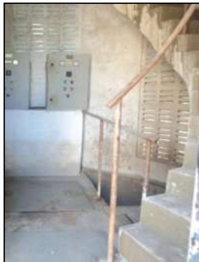
Figura 7: EEEB1 sem sinalização e acesso restrito. Ambiente necessitando de pintura.
