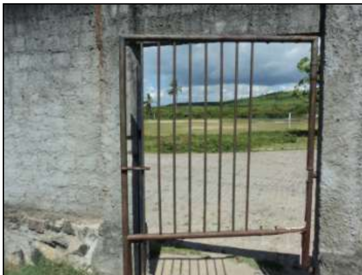
Figura 12: Portão danificado na área da ETE
