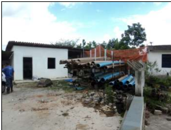
Figura 4: Área da reservação com acúmulo de tubulações.
