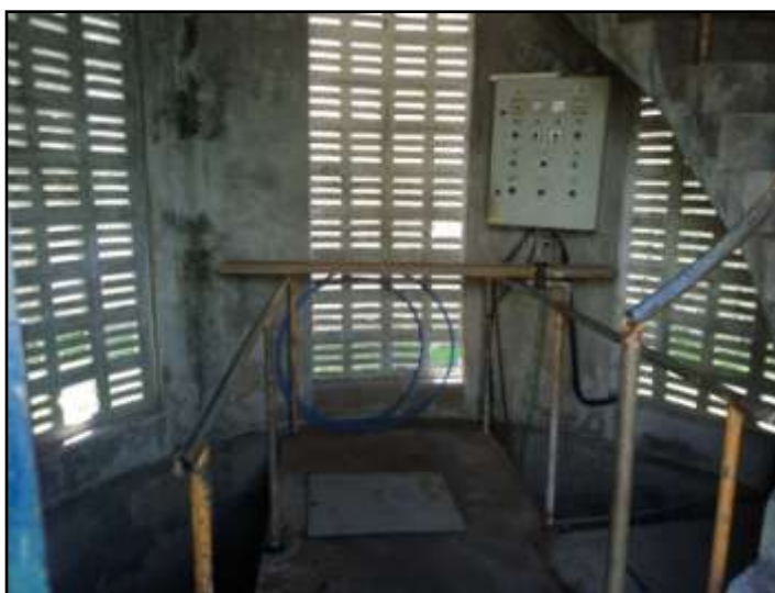
Figura 11: Fiação exposta do quadro de comando.
