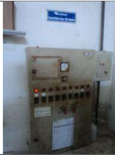
Figura 8.8 – Painel elétrico da dosadora de sulfato de alumínio
