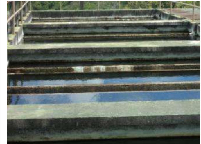
Figura 8.3 – Filtros em estado de conservação deficiente
