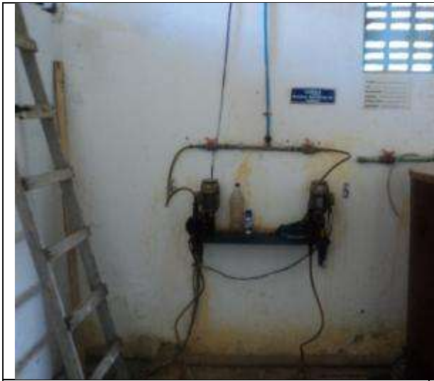
Figura 8.7 – Bomba dosadora de sulfato de alumínio
