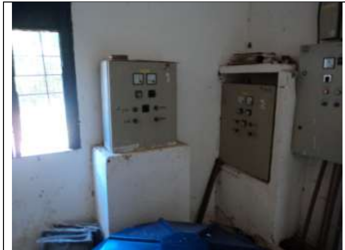
Figura 8.2 – Edificação em estado deficiente de conservação
