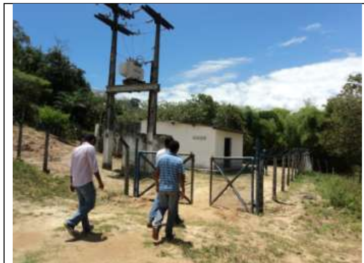
Figura 8.1 – Ausência de sinalização na área da captação
