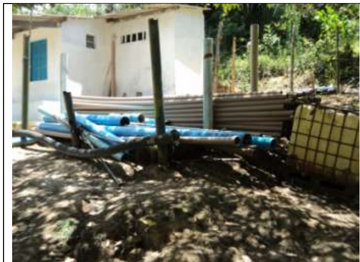
Figura 8.3 – Materiais dispostos de forma inadequada
