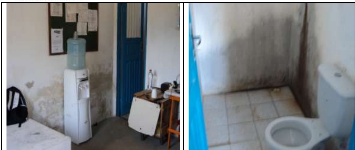
Figura 8.4 – Instalações em estado precário
