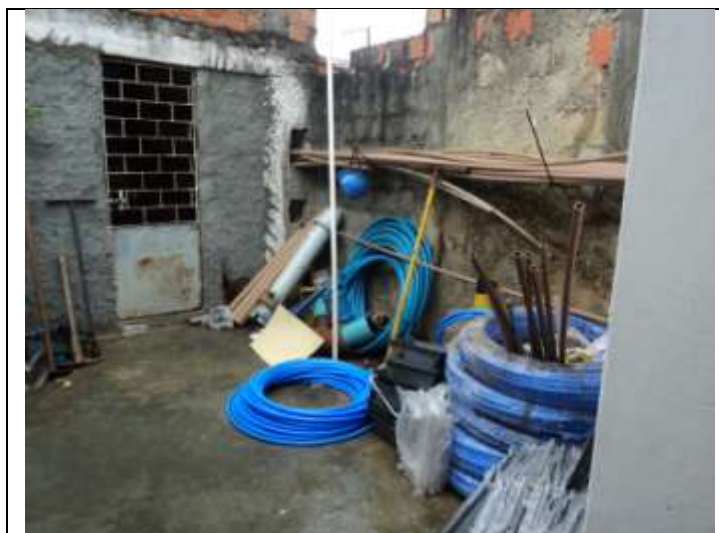
Figura 8.12 – Materiais dispostos de forma e em local inadequados
