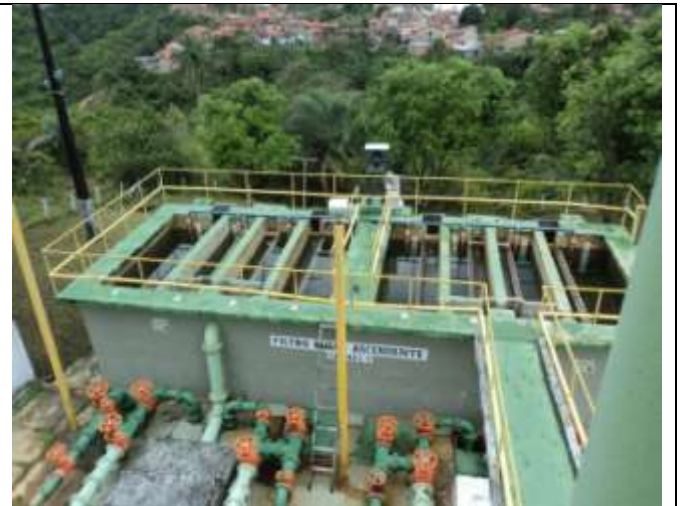
Figura 6.3 – Vista dos filtros russos da ETA
