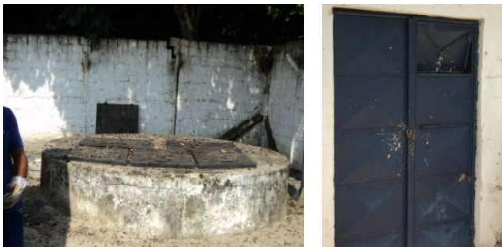
Figura 9.6 – Instalações físicas da EEE-07
