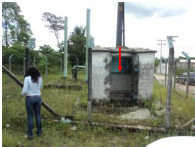
Figura 8.6 – Cerca de proteção do Poço 05 danificada
