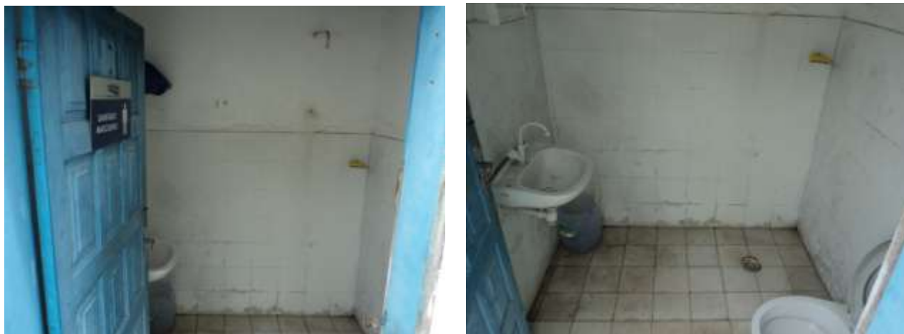
Figura 8.8 – Banheiro com instalações precárias
