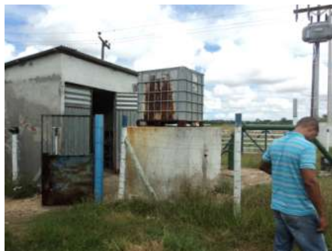
Figura 8.7 – Cerca de proteção do Poço 10 danificada
