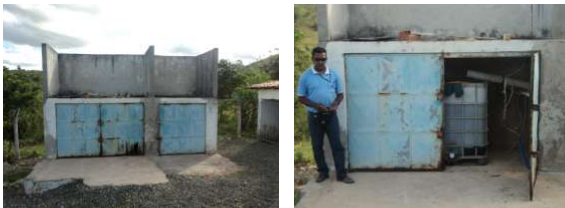
Figura 8.5 – Interior da Casa de Cloração do Poço 06
