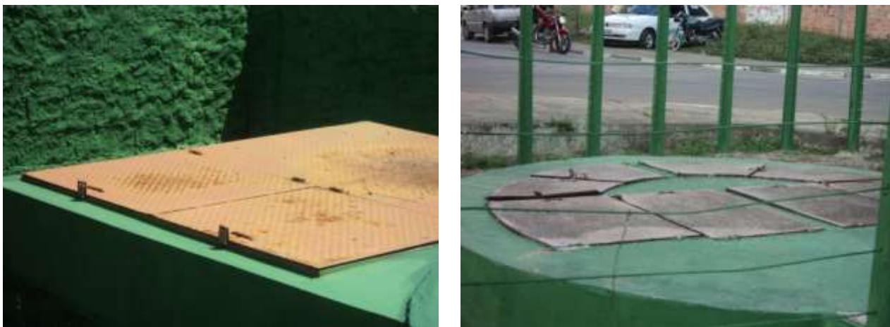
Figura 9.4 – Poços de visita da EEE-06 (à direita) e da EEE-01 (à esquerda) sem cadeados
