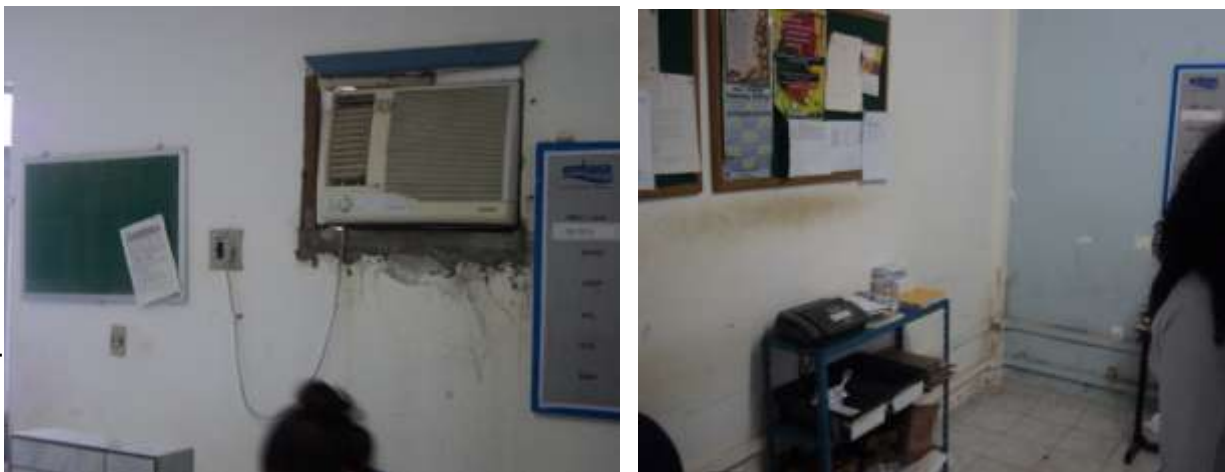
Figura 8.8 – Instalações obsoletas e necessitando de reparos
