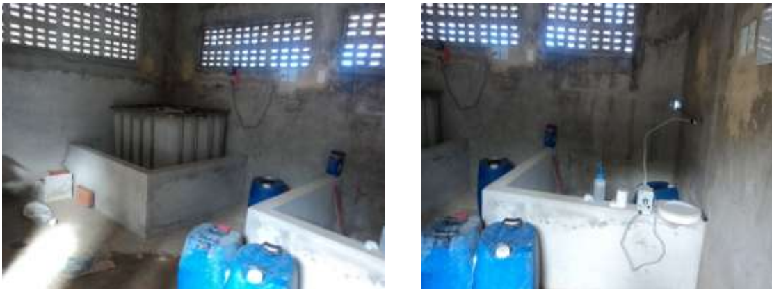
Figura 8.4 – Interior da Casa de Cloração do Poço 08
