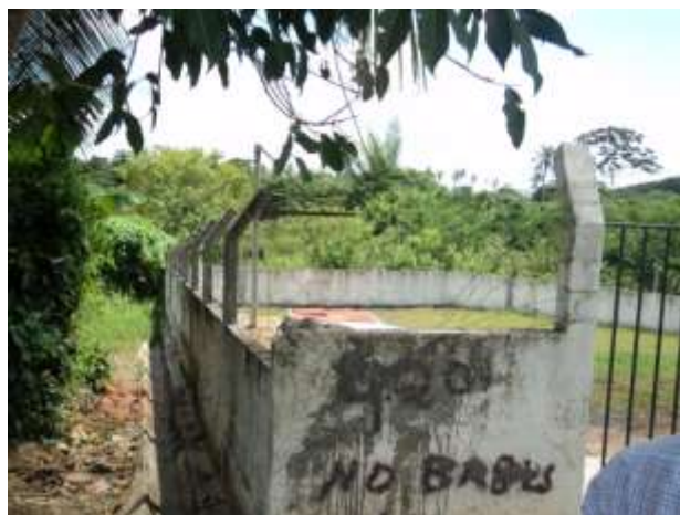
Figura 9.5 - Cerca de proteção e isolamento danificada
