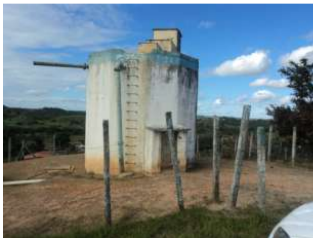
Figura 8.6 – Reservatório que atende a localidade de Monte Líbano
