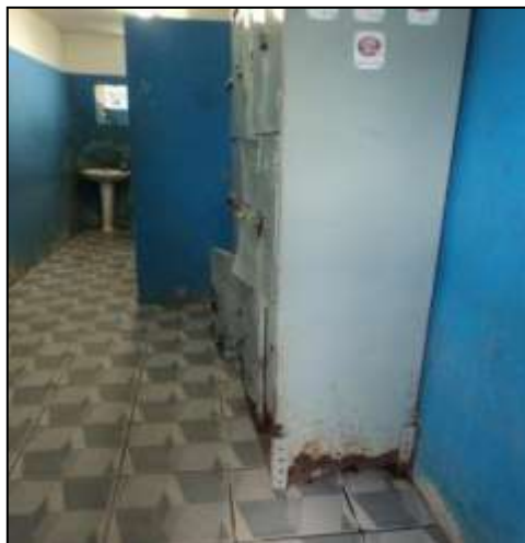
Figura 15 - Interior das instalações do Escritório Local de Simões Filho apresentando móveis danificados
