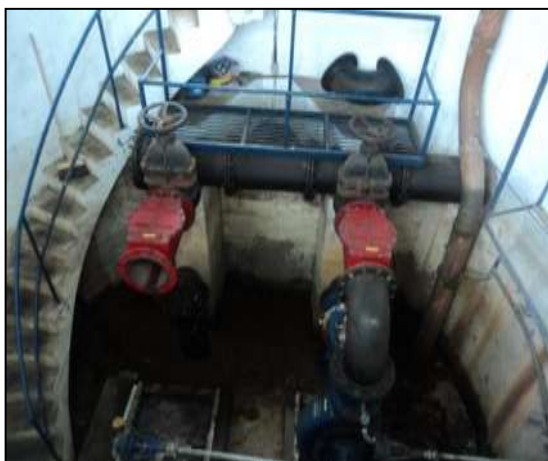
Figura 25 - Área interna da EEE km 30 Baixo
