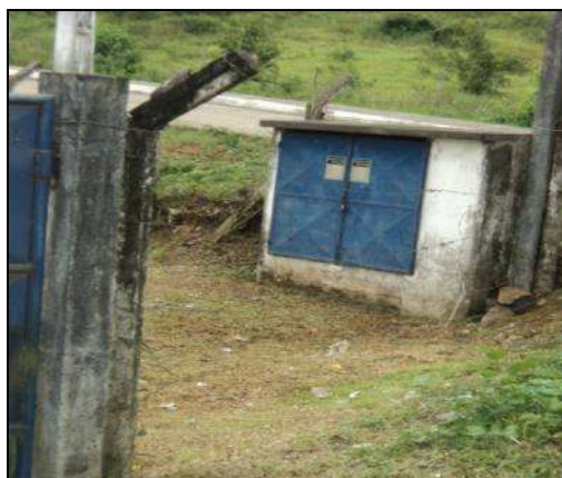
Figura 20 - Edificação do quadro de comando da EEE B. Área em mau estado de conservação
